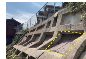
法枠内土砂流出防止
